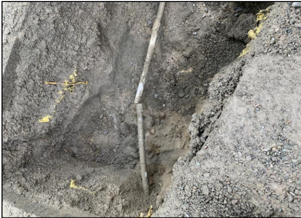
Broken Electrical Conduit
