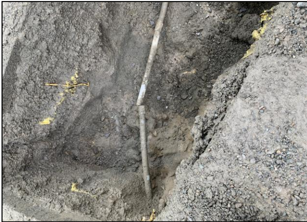
Broken Electrical Conduit
