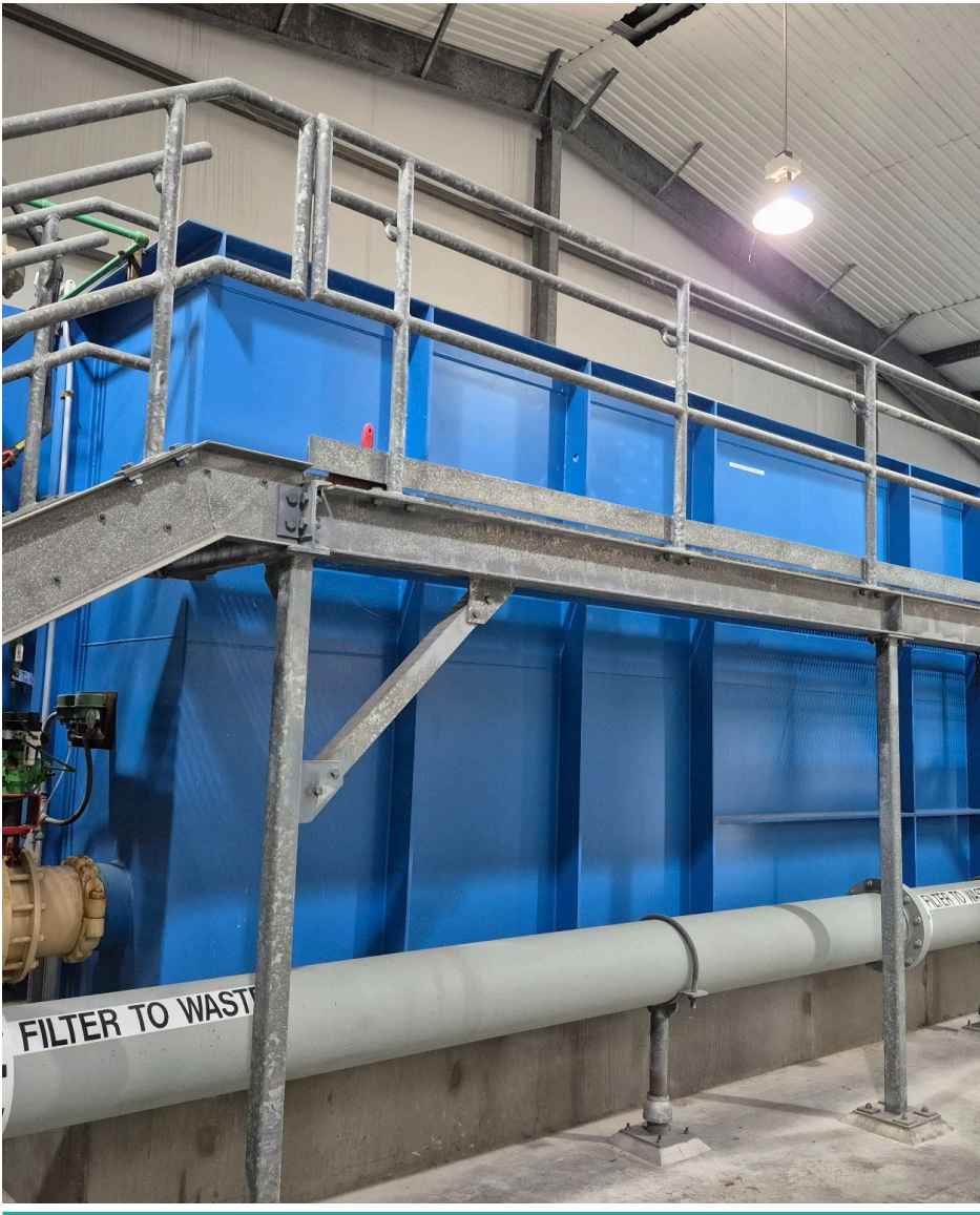
Actual WTP 3 Trident unit exterior.
