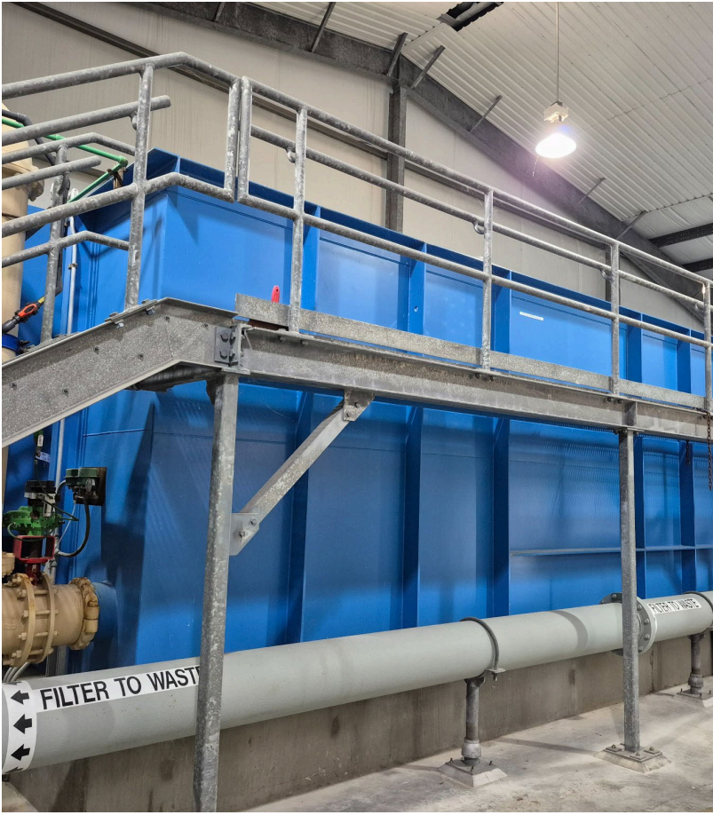
Actual WTP 3 Trident unit.
