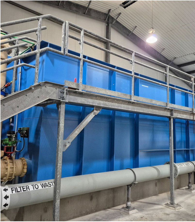
Actual WTP 3 Trident unit.
