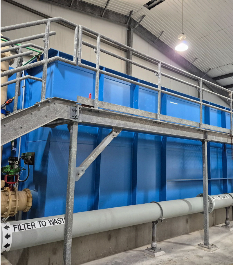
Actual WTP 3 Trident unit.
